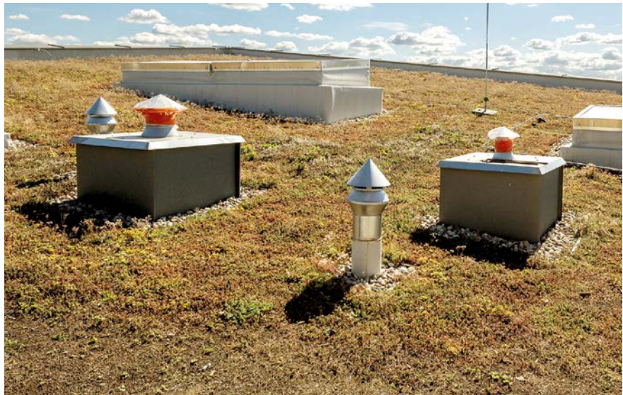
Na dachu umieszczone zostały rośliny z rodzaju rozchodników, które rosną na suchych i piaszczystych podłożach. Podłożem w przypadku dachu przedszkola są porowate skały wulkaniczne, które zatrzymują wilgoć, niezbędną do życia tych roślin.
