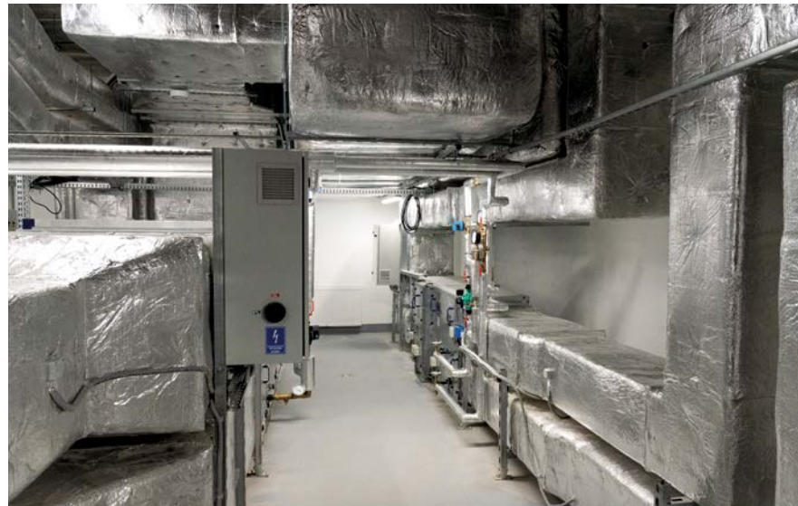
Wentylatornia – przed usunięciem zużytego powietrza z budynku odzyskiwane jest zgromadzone w nim ciepło.
